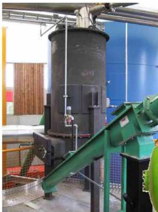
200 kW updraft gasifier
